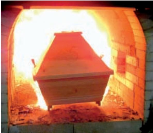
Abb. 4: Blick in eine Brennkammer (Foto: S. Ippisch)
